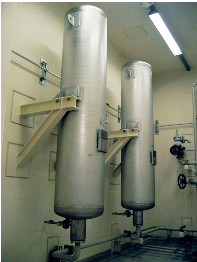
Application: compensation de volume Client: centrale nucléaire Gösgen Produits ORELL utilisés: accumulateurs à vessie EBV 530 avec homologation nucléaire
